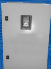
Para bombeo solar
